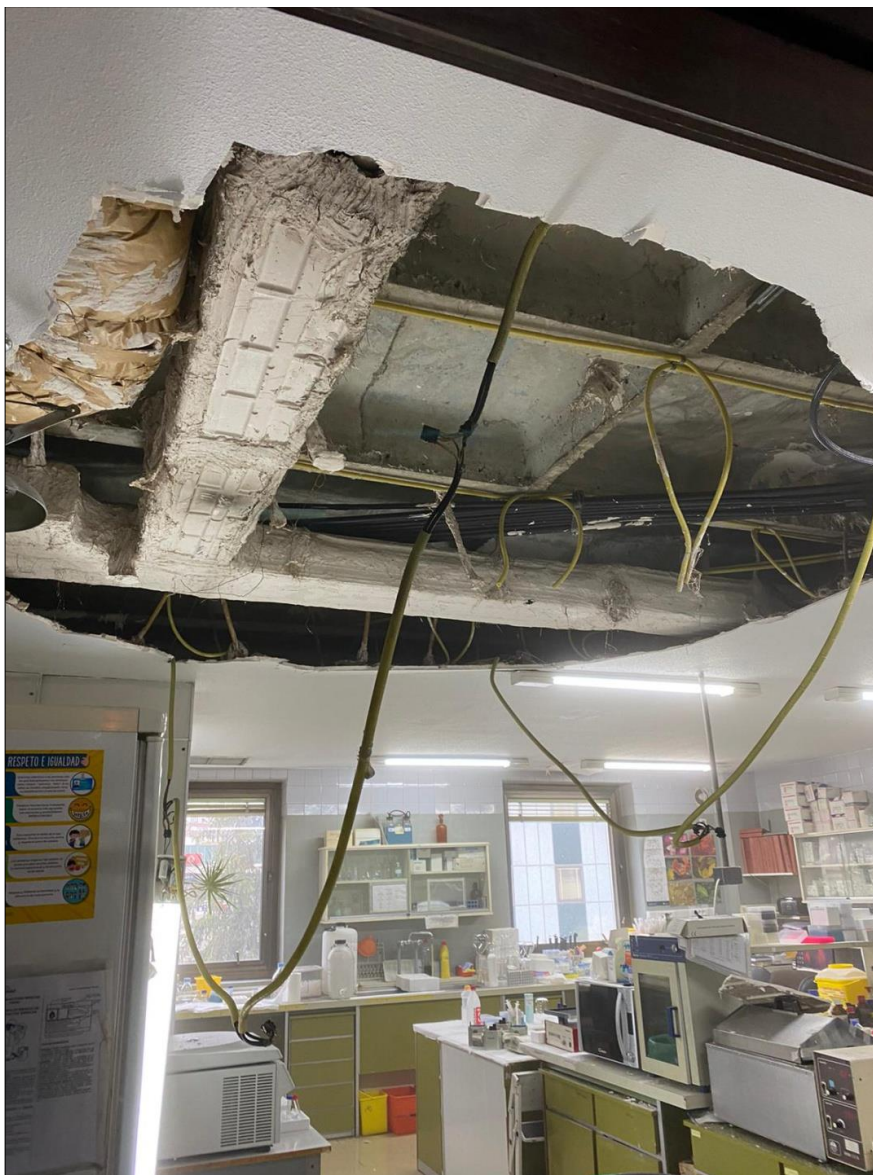
Imagen del techo caído sobre un laboratorio del hospital madrileño Ramón y Cajal. / CCOO
